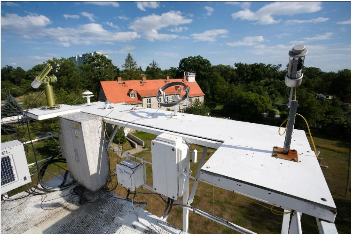
Fotometr zainstalowany na wieży aktywności.
